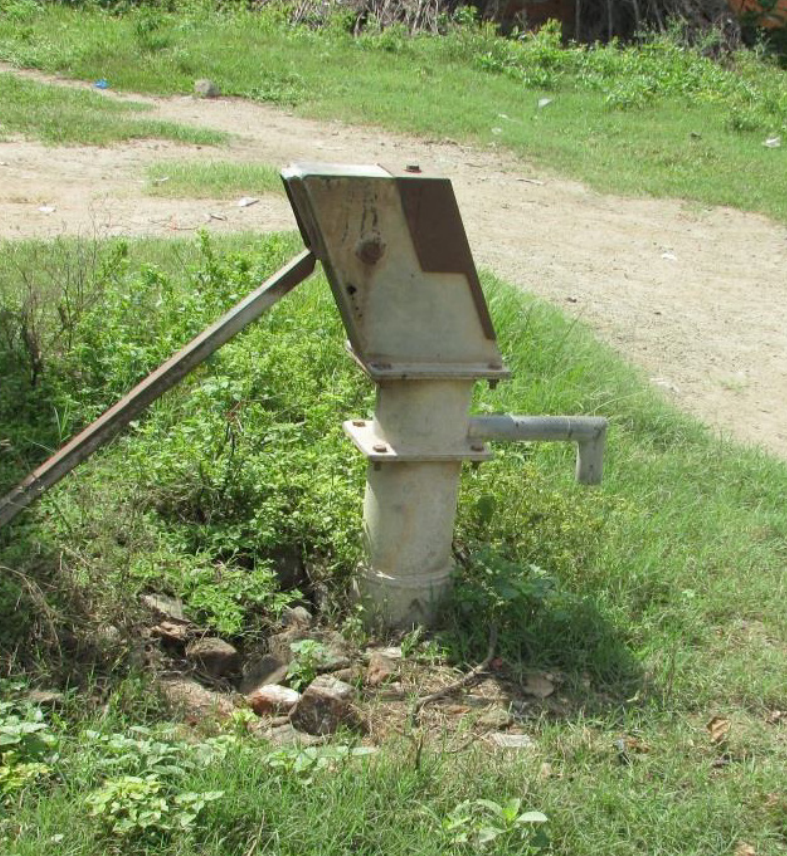
EN HANDPUMP SOM VAR DEN FRÄMSTA KÄLLAN TILL DRICKSVATTEN ÄR UNDER REPARATION
